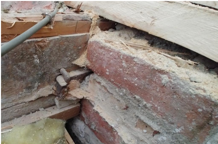
Figur 2: Trebjelke ved opplegg i yttervegg mot vest ved hjørne mot øst. Målt fuktinnhold er ca. 9,9 vektprosent.
