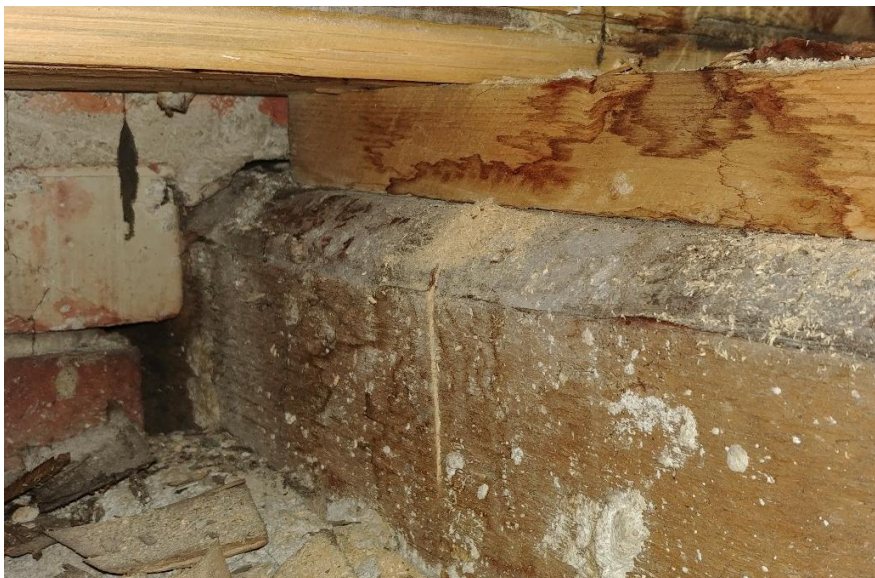
Figur 3: Trebjelke ved opplegg i yttervegg mot øst nært hjørne mot sør. Målt fuktinnhold er ca. 8,0 vektprosent. Skjolder i treverket kan tyde på tidligere oppfukting. Ved flere av de andre stikkprøvene hadde bjelkene tilsvarende skjolder.
