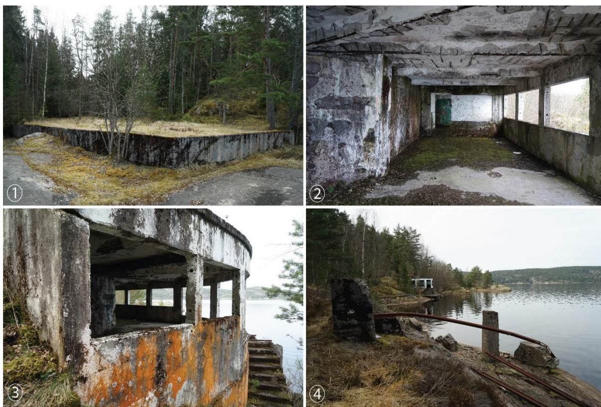
Figur 7. (1) Foto av dansegulvet tatt fra restaurantens uteservering. (2) Foto tatt inne i restauranten. Skader i armeringen er synlige. (3) Restauranten og trappene ned til brygga. (4) Rester av badehus og stupetårn i forgrunnen og betongkonstruksjonen etter restaurantbygningen i bakgrunnen (hvit konstruksjon).
